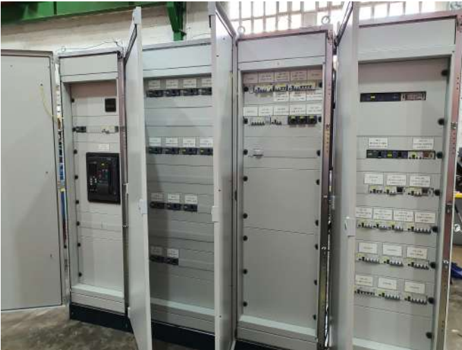
CUADRO BAJA TENSIÓN EQUIPEL
