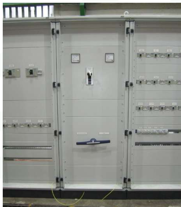
CUADRO BAJA TENSIÓN EQUIPEL
